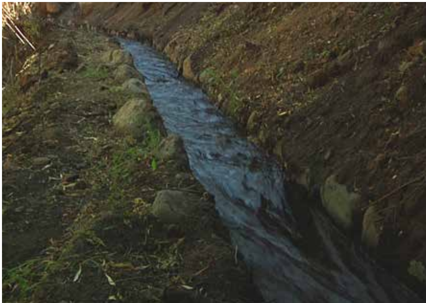
FIGURA 7. Canal en ladera de cerro.
