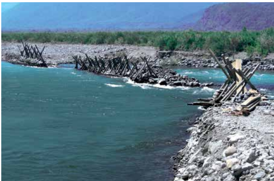
FIGURA 6. Bocatoma rústica colapsada sobre el río.
