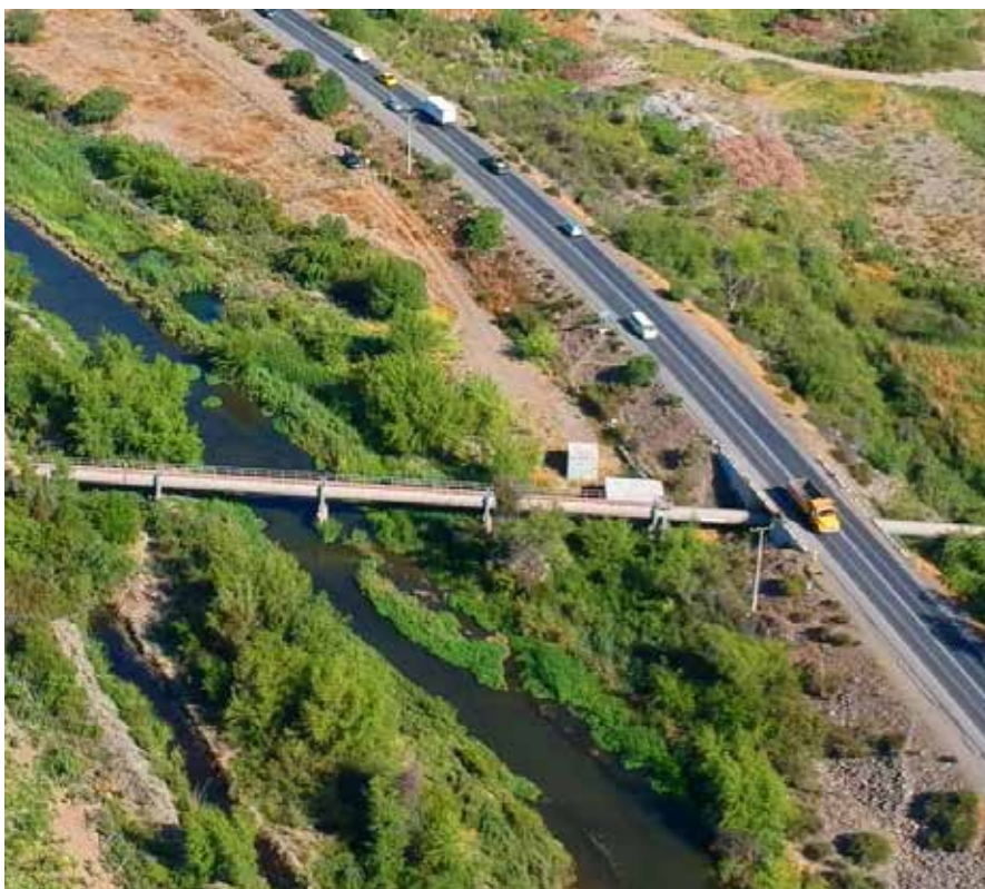
FIGURA 11. Sifón que atraviesa río y carretera.
