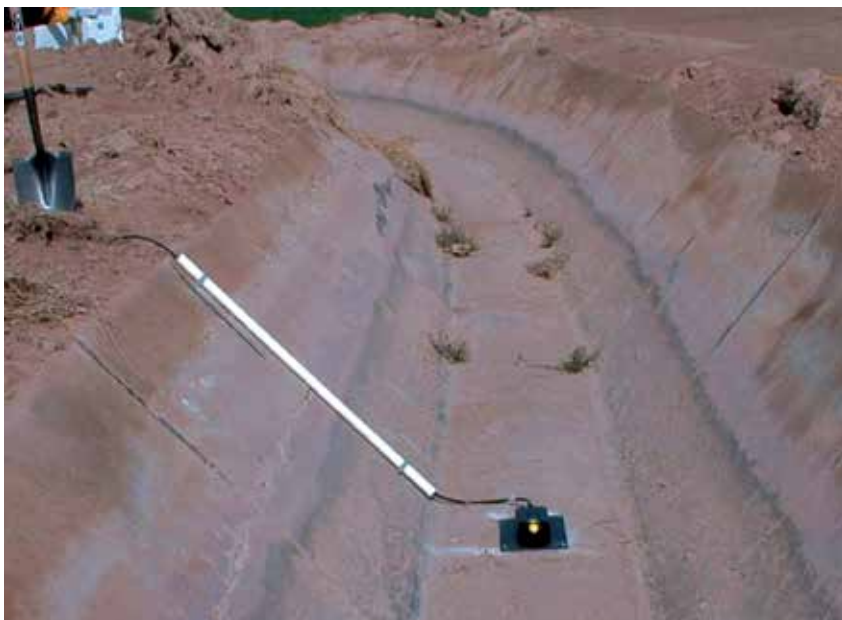
FIGURA 23. Sistema de telemetría instalado en un canal de regadío.
