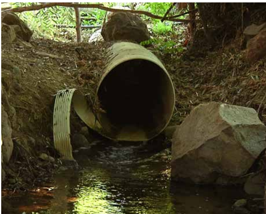
FIGURA 9. Colapso de tubería.
