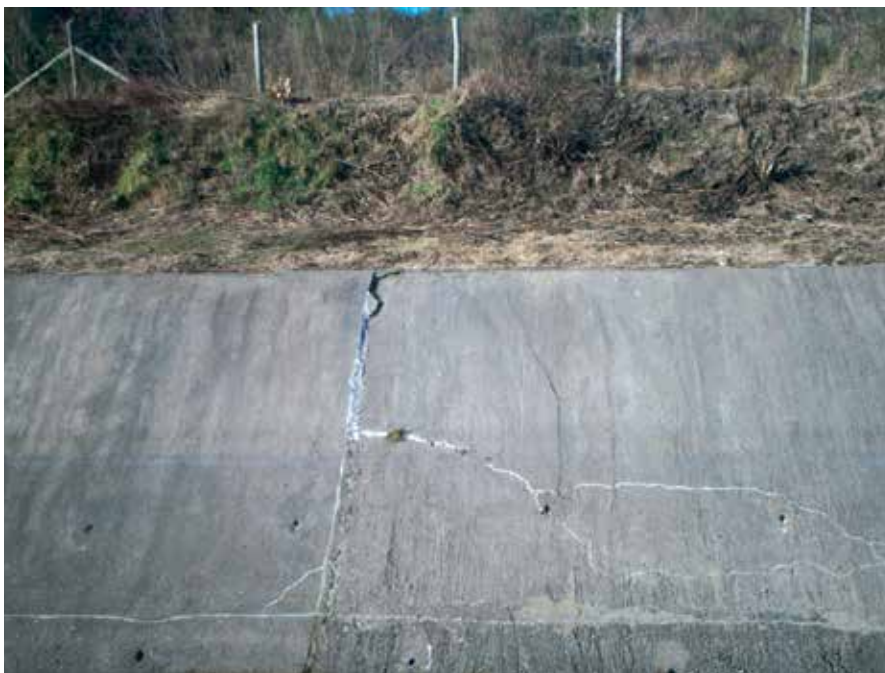
FIGURA 8. Fisuras en revestimientos de hormigón.
